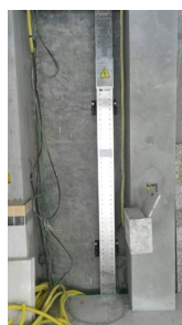
Busway em Duto de Parede
