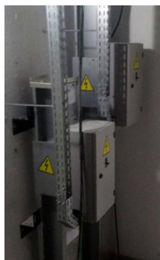
Busway + Painéis — Detalhe de Obra
